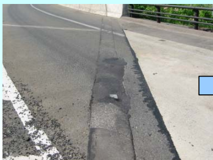
施工前の橋の継ぎ手部分です 舗装が傷んで段差が生じていました
