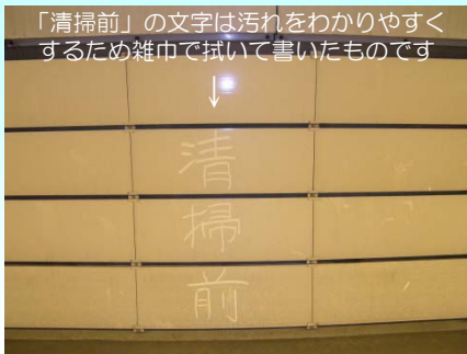
「清掃前」の文字は汚れをわかりやすくするため雑巾で拭いて書いたものです ↓ 清掃前のトンネルの壁面で車の排気ガス等で黒く汚れています
