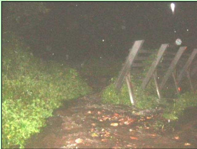
① 土砂が道路に流出 145.3kp 板敷
