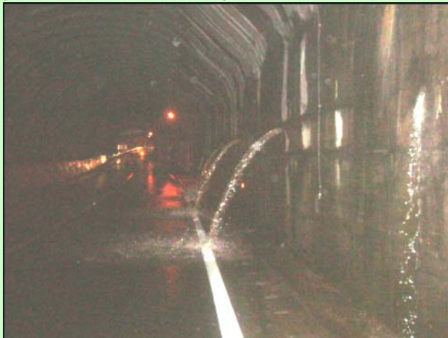
③ 水が吹き出し 148.2kp 高屋スノーシールド
