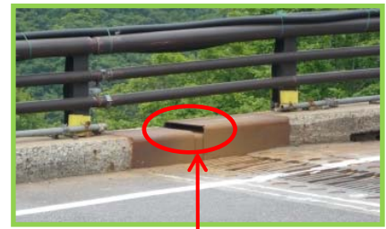
段差が生じています！
