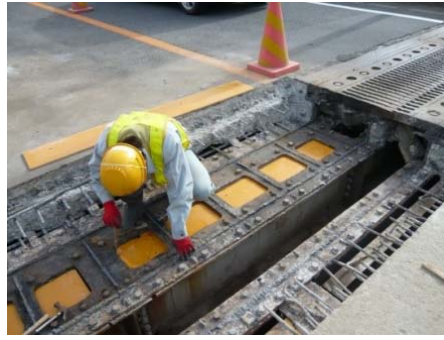
②新しい伸縮装置を設置するために型枠を設置します
