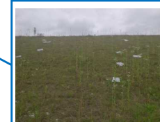
置賜白川左岸 No.3-55 しらかわ大橋下流 表法面へ生活ゴミ散乱 生活ゴミの散乱 (古新聞・衣類) 6月15日確認 ※回収
