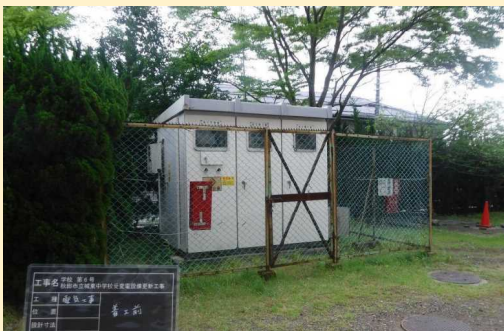
屋外にあった受変電設備
