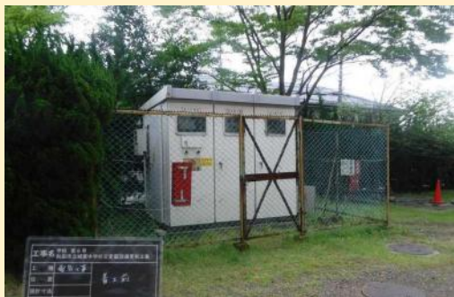
屋外にあった受変電設備
