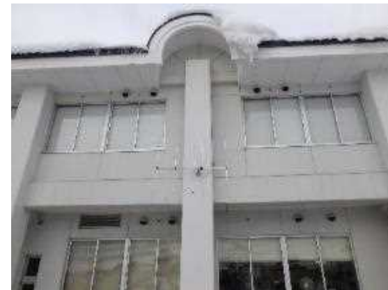
防災ラジオ個別屋外アンテナ設置状況
