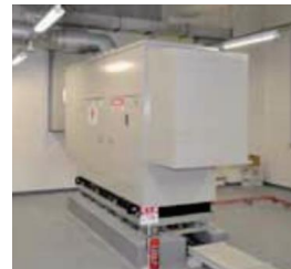
非常用発電設備のイメージ
