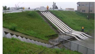
排水ポンプ車による排水状況 (大仙市浜町地区)
