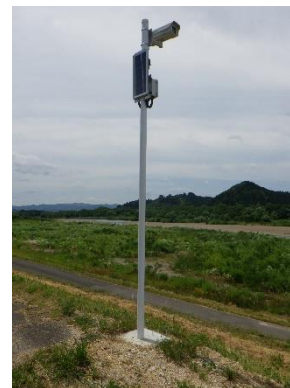
簡易型河川監視カメラ設置状況
