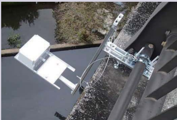
現場実証実験第一弾(鶴見川水系 鳥山川)
