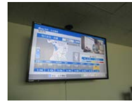
参考-3 データ放送による水位監視
