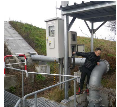
参考-4 丸子川沿いに設置している常設排水施設
