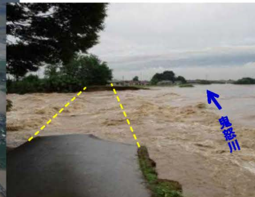
被災状況(拡大写真)
