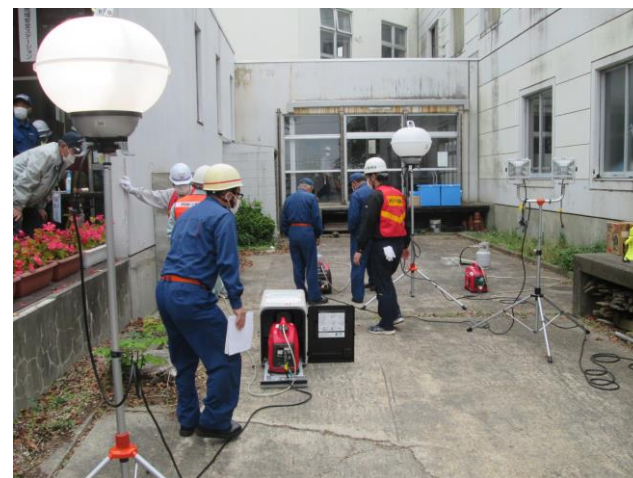
【土砂災害訓練】秋田県LPガス協会による給電訓練
