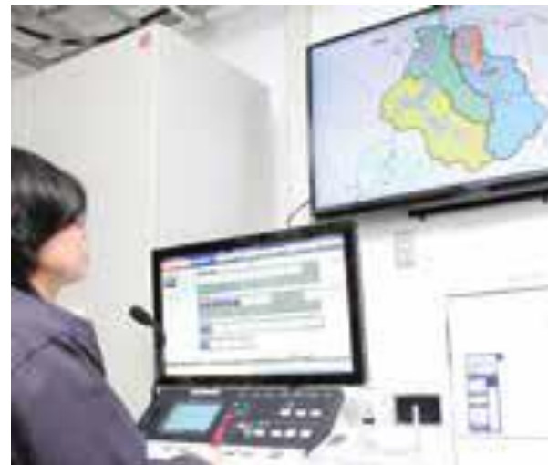
防災行政無線施設（操作卓）
