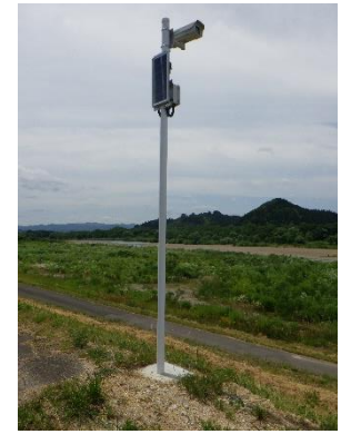
簡易型河川監視カメラ設置状況
