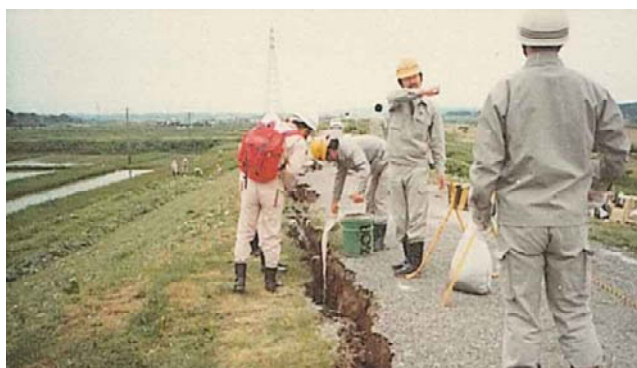
日本海中部地震で発生した堤防の亀裂に石灰水を注入することにより亀裂深を調査（秋田市牛島地区）
