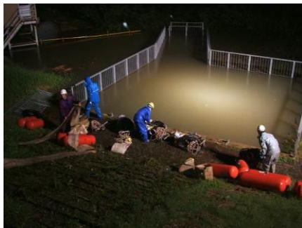
浜町排水ピット
