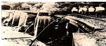
田沢湖線被害状況（昭和35年）
