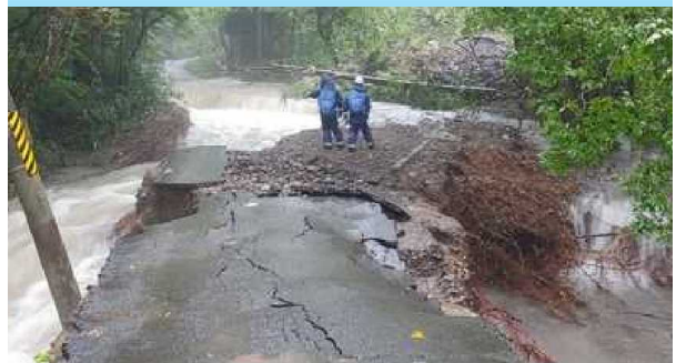
令和4年8月 前線停滞による豪雨 TEC-FORCEによる被災状況確認(深浦町)
