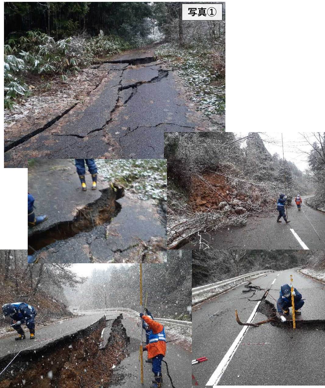
被災状況調査
