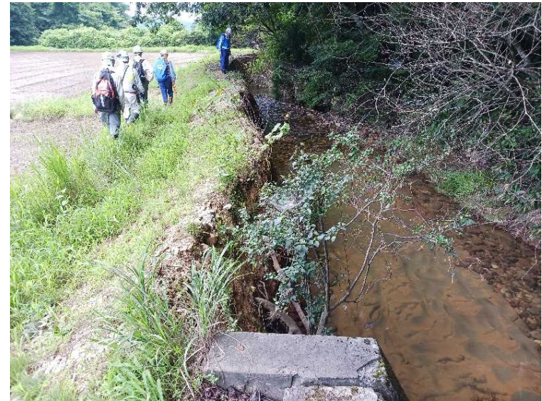
被災概要調査（峰浜埧地内）
