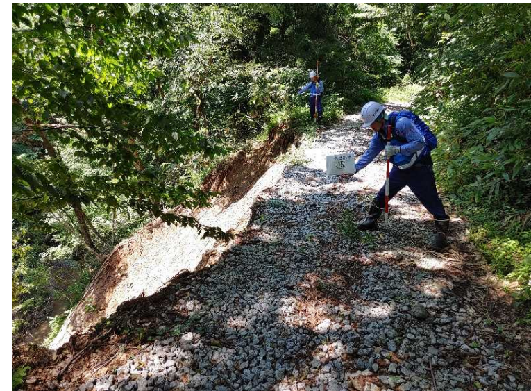
被災概要調査（馬場目地内）
