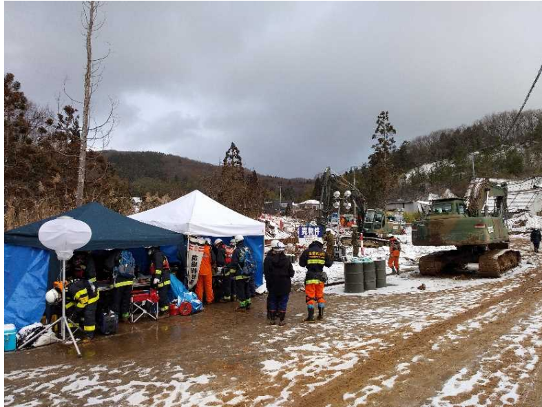
被災現場状況
