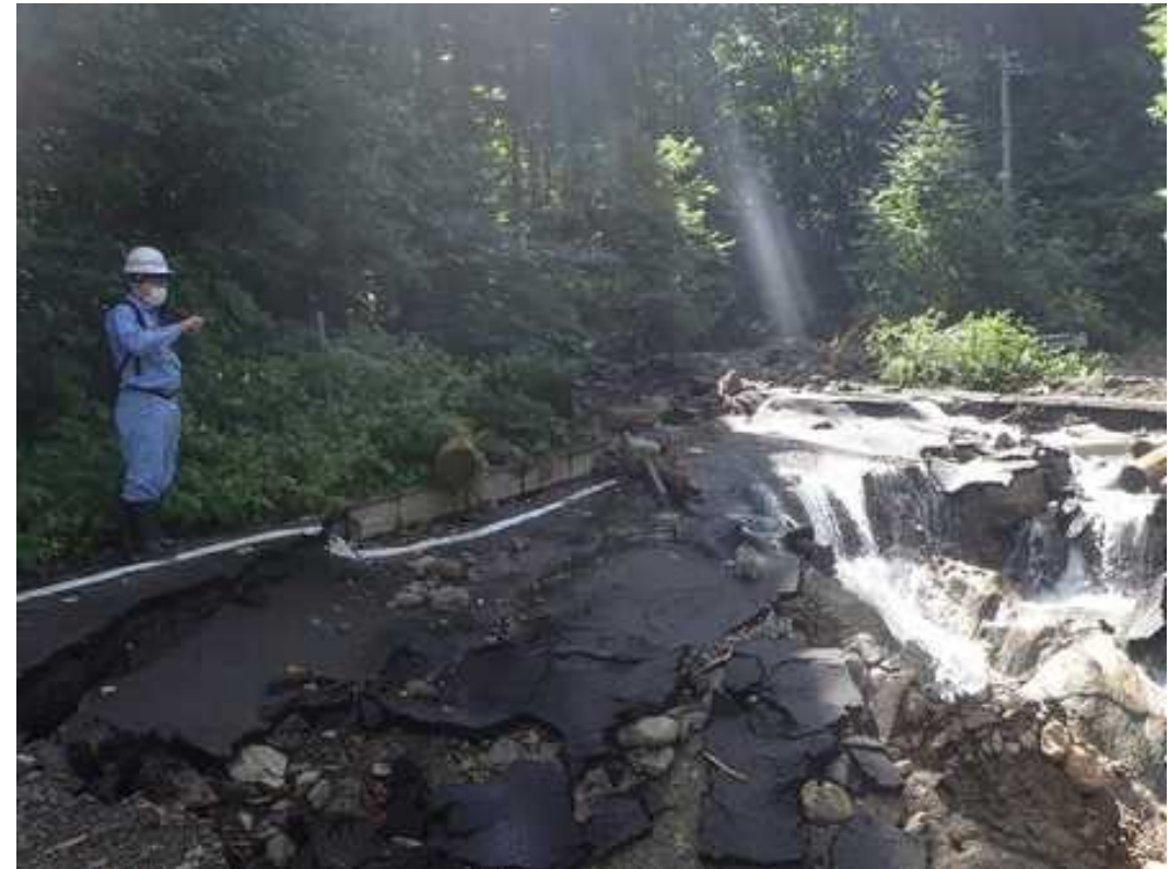
被災状況調査（大字深浦地内）
