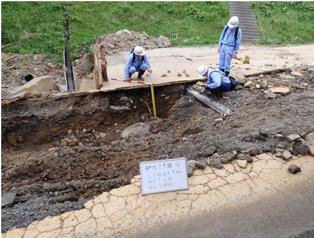
被災状況調査（舟作地内）
