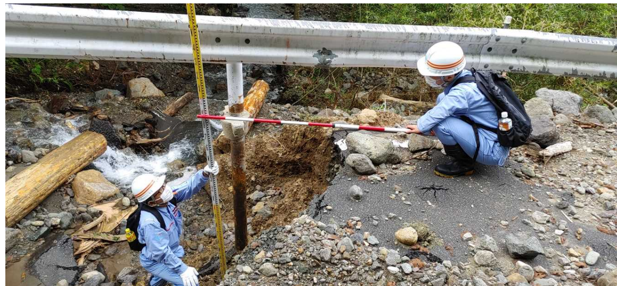
被災状況調査（大字深浦地内）
