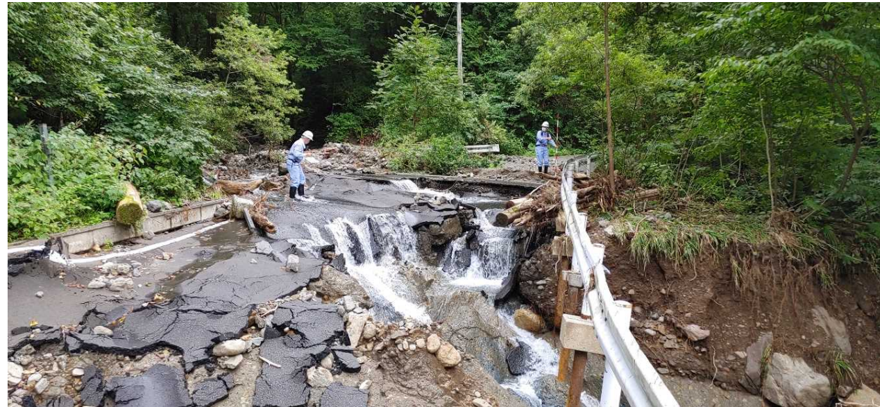
被災状況調査（大字深浦地内）
