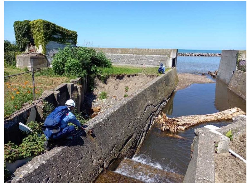
被災状況調査（漁師町）
