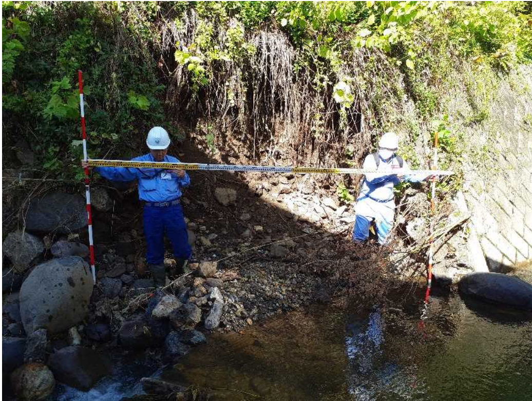
被災状況調査（岩崎地内）
