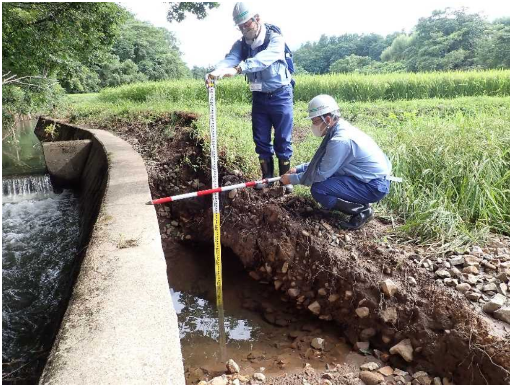
被災状況調査（小成沢川）
