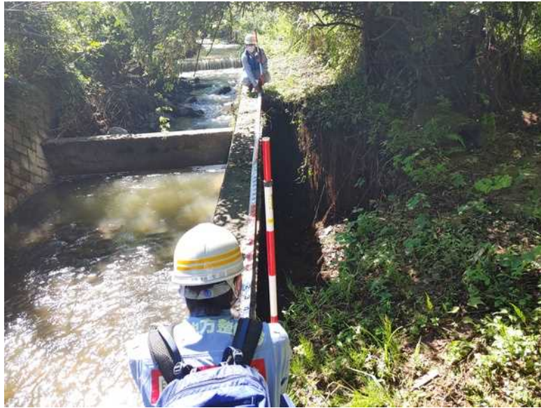
被災状況調査状況（田野沢地内）
