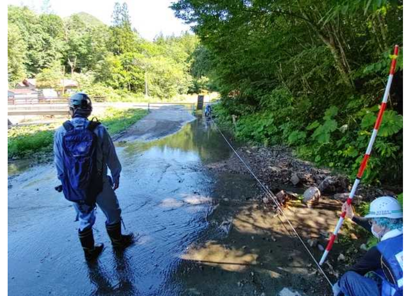
被災状況調査状況（上長慶平地内）
