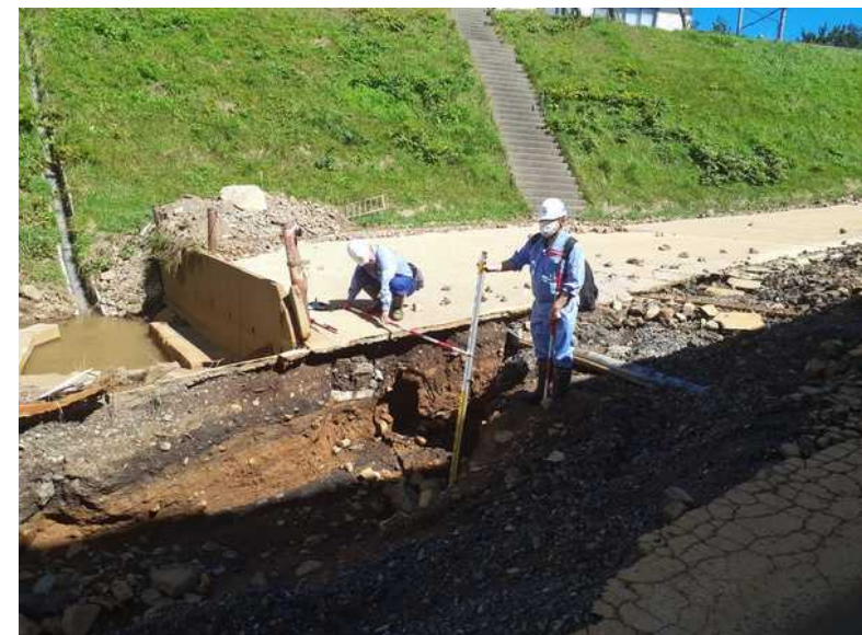
被災状況調査状況（舩作地内）
