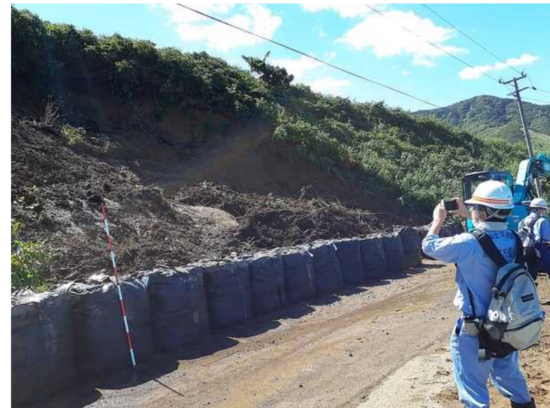
被災状況調査状況（小泊地内）
