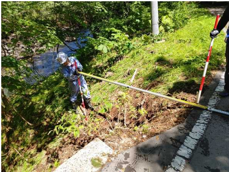
被災状況調査状況（上長慶平地内）
