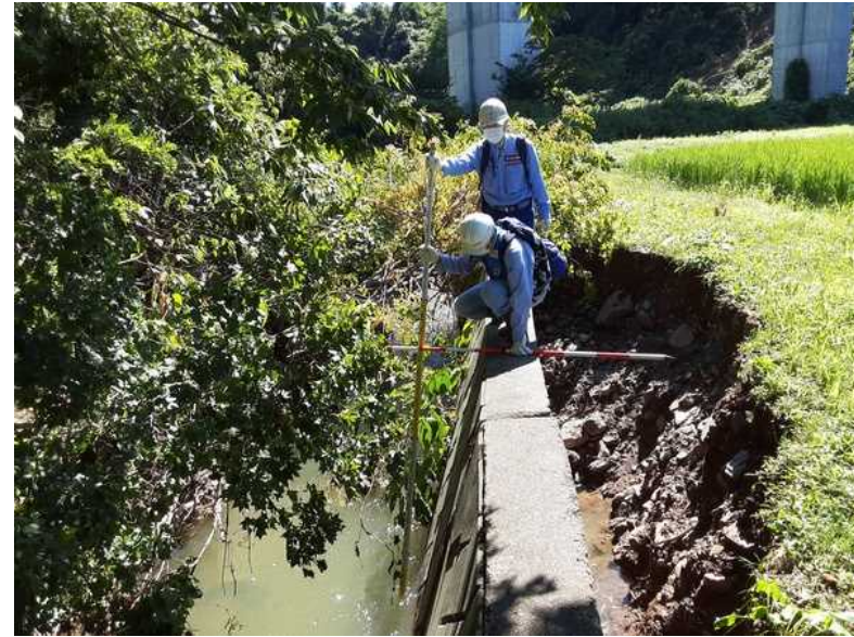
被災状況調査状況（田野沢地内）
