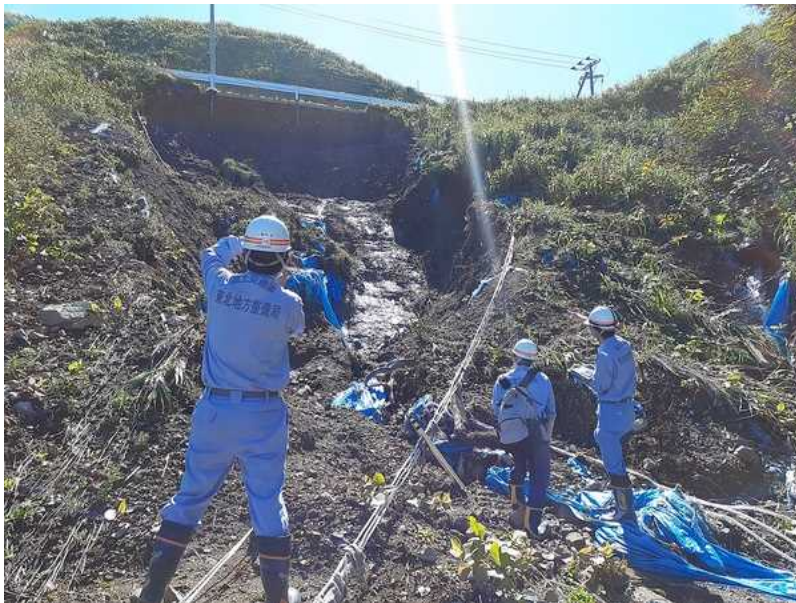
被災状況調査状況（小泊地内）
