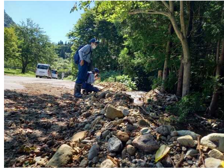
被災状況確認（一ツ森町地内）
