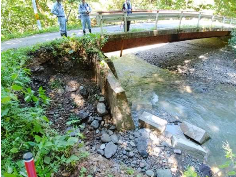
被災状況調査状況（上長慶平地内）
