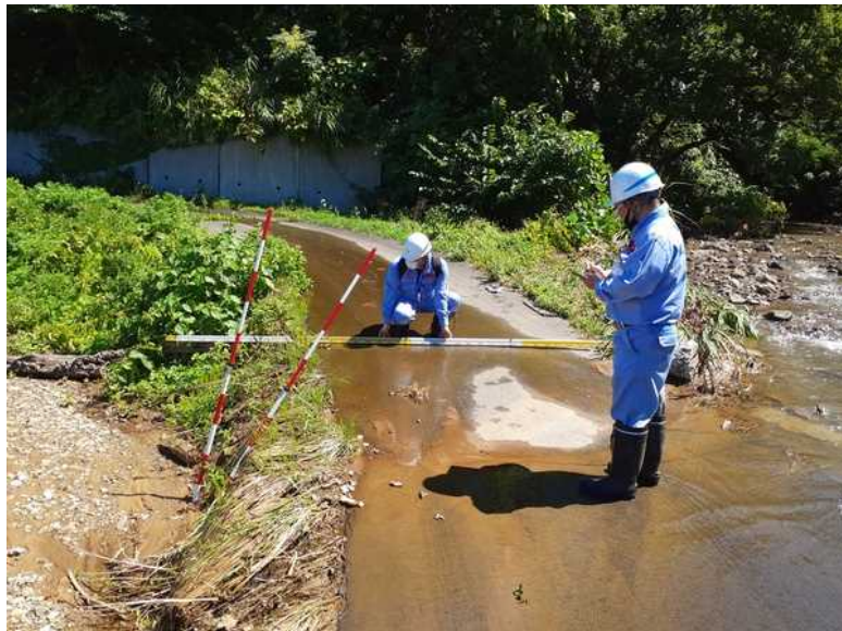
被災状況調査状況（横磯地内）
