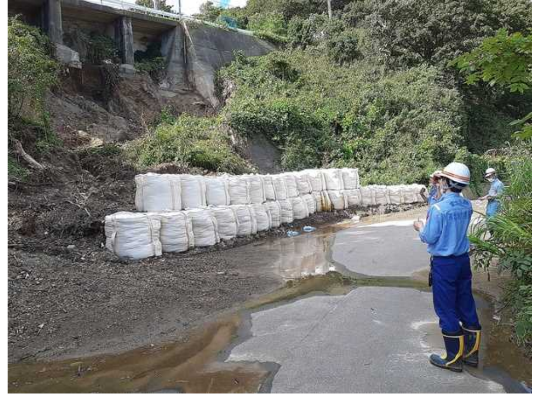
被災状況調査状況（下前地内）
