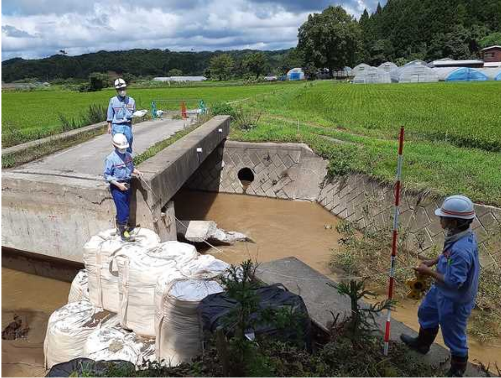
被災状況調査状況（袴腰山地内）
