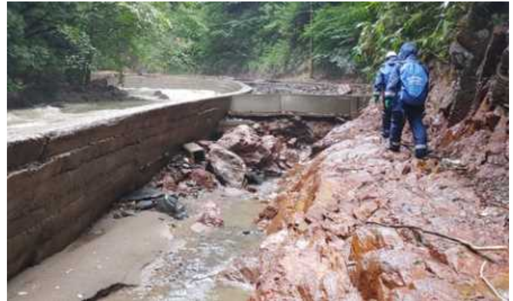
被災状況の確認（長慶平地内）
