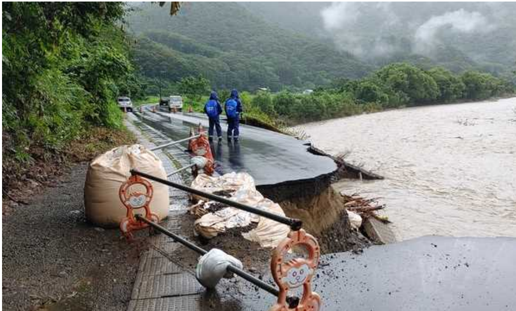
被災状況の確認（追良瀬地内）
