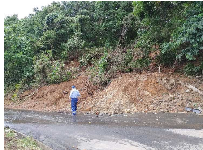
被災状況確認（月屋地内）
