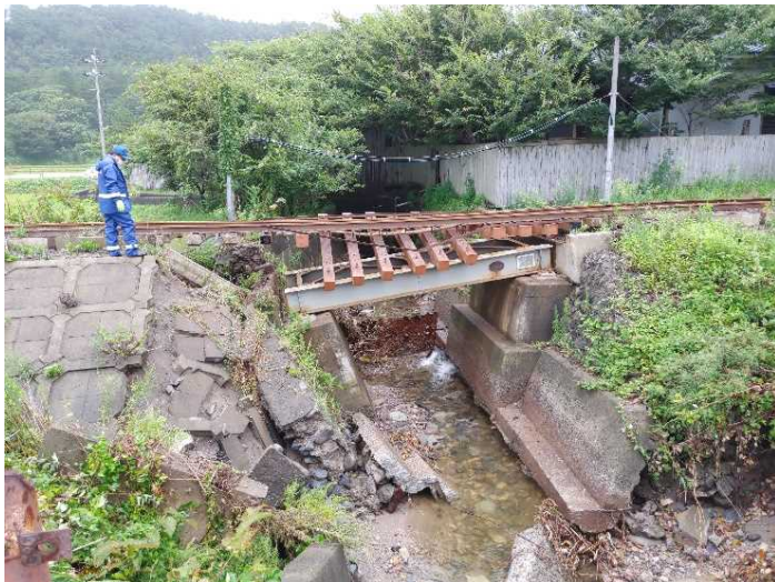
被災状況確認（松神地内）
