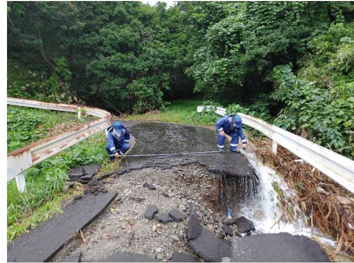
被災状況計測（黒崎地内）
