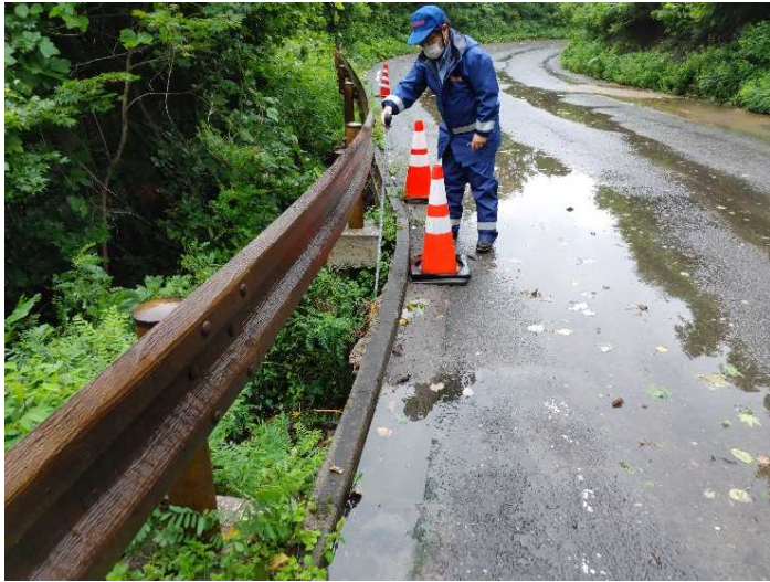
被災状況計測（松神地内）
