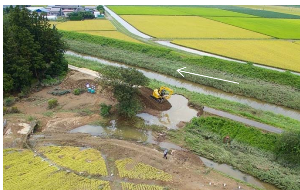
上流工区破堤箇所(13日12:00)
