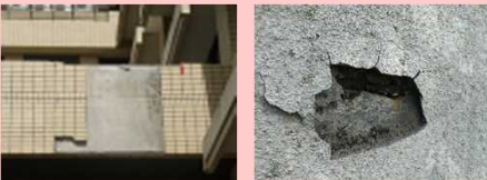
外壁タイルの一部が階下へ落下
