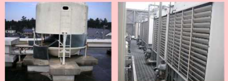
壊れかけた冷却塔
