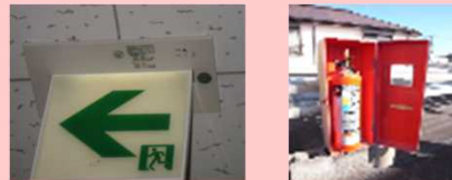
点灯しない電池切れの 避難誘導灯
