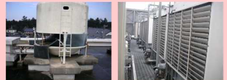
壊れかけた冷却塔
