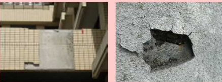
外壁タイルの一部が 階下へ落下
