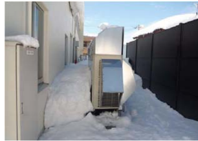
【屋外機の埋没】
