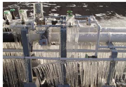
【配管の凍結破損】
