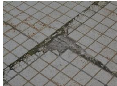
【凍害による床の段差】
