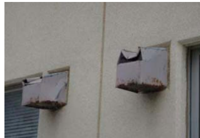
【フードの破損】
