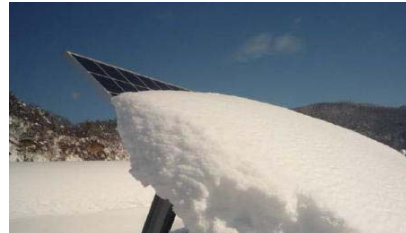
【太陽光パネルへの積雪】
