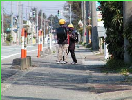
斜めになった現在の歩道
