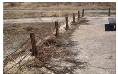
柵のロープのゆるみ箇所→ (ロープ張り直して対応)
