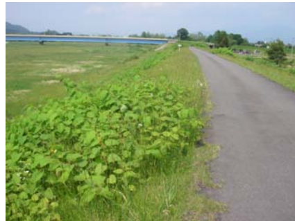
繁茂状況(この状態だと堤防の変状やゴミの確認ができません)
