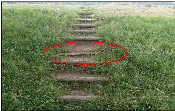
●木製階段の破損
