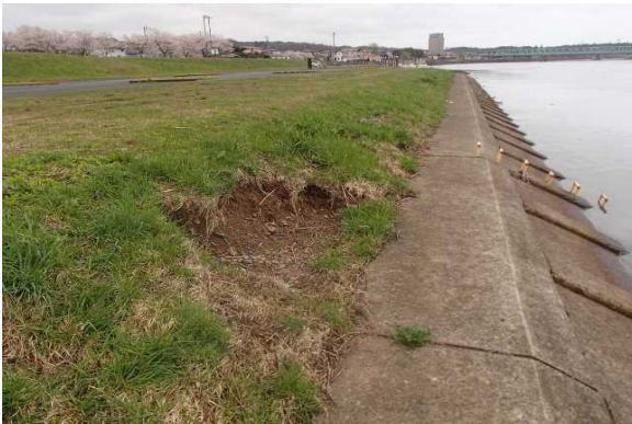
低水護岸の天端浸食
