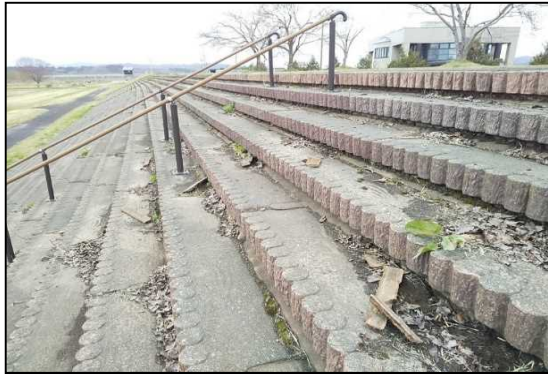
階段護岸に土砂等の堆積
