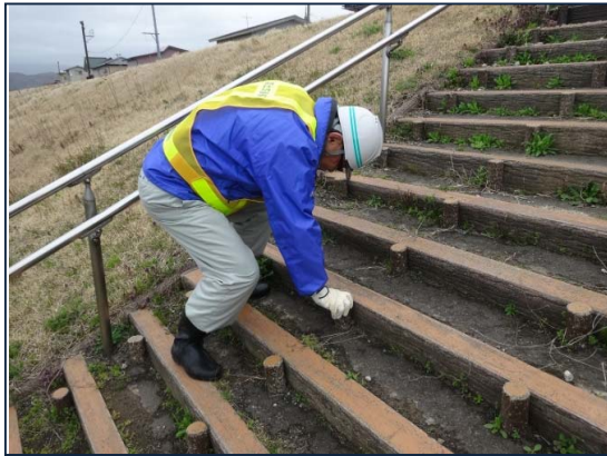
▲堤防から公園に降りる階段と押さえ杭の間に段差が生じていたため、躓くおそれがありました。(由利本荘市:せせらぎパーク)
