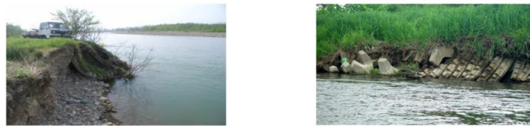
河岸崩壊の状況
