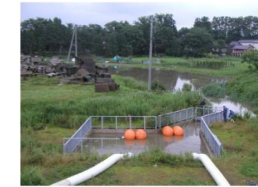
角間川排水ピット
