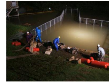
浜町排水ピット
