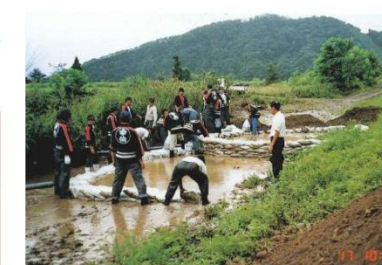
漏水被害の状況 (秋田県大仙市鍵見内地先)
