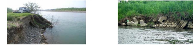
河岸崩壊の状況
