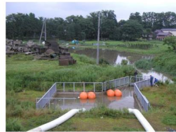
角間川排水ピット
