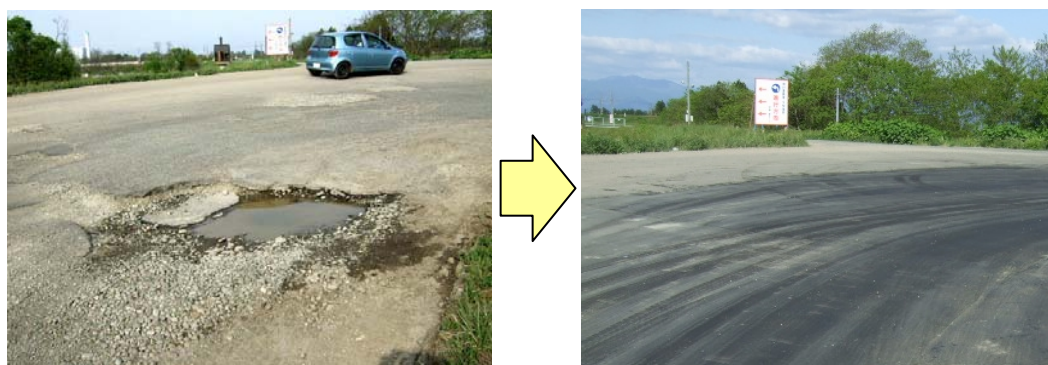
堤防の天端舗装補修前の状況
