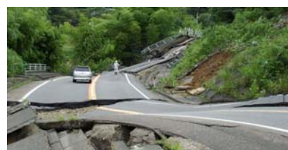
被災状況調査
