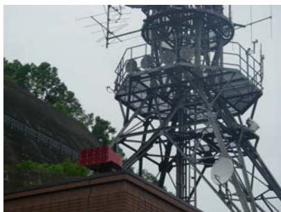
玉川ダム 放流警報施設
