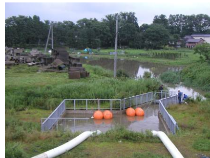
15 角間川排水ピット
