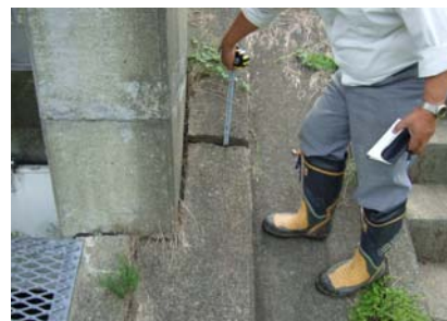
樋門・樋管の変状状況
