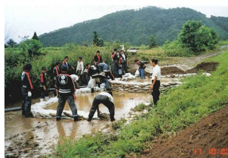
35 漏水被害の状況 36 (秋田県大仙市鍵見内地先) 37 やりみない
