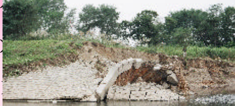
被災状況 (下開護岸)
