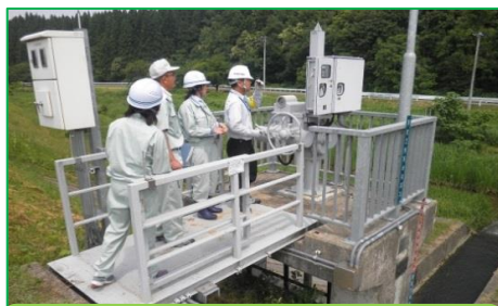
ゲート開閉の動作確認
