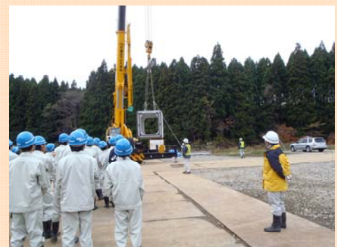
クレーンで函渠を吊り上げている様子【福部樋門新設工事】
