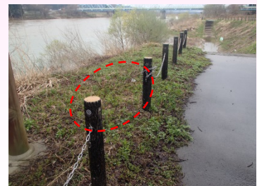
転落防止柵のチェーンが破断している状況を確認
