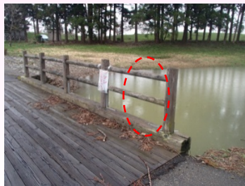
渡り橋の手すりの根本部分が腐食し、折れる危険あり
