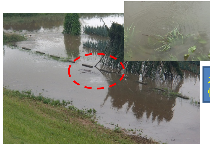
河川巡視により漏水箇所を発見
