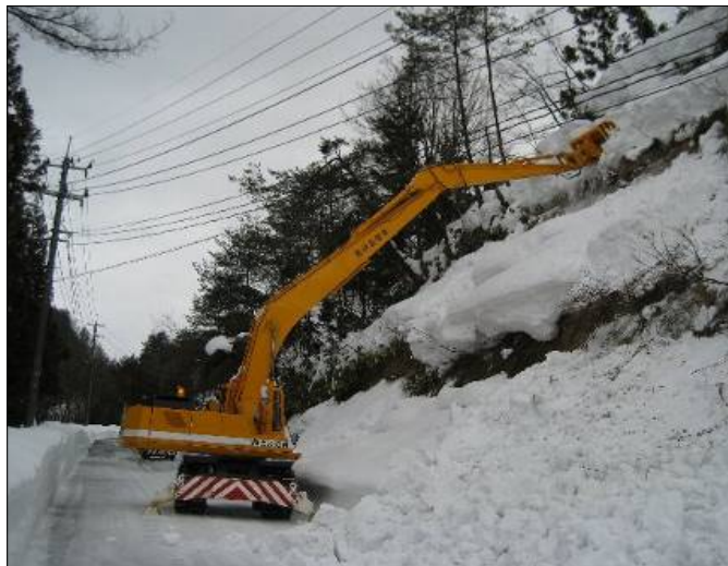
町道で活躍する雪庇処理車
