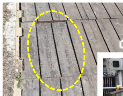
木橋の板の損傷
