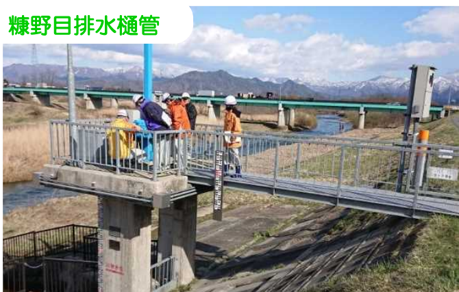
▲ ゲートを操作し、異常がないか確認中!
