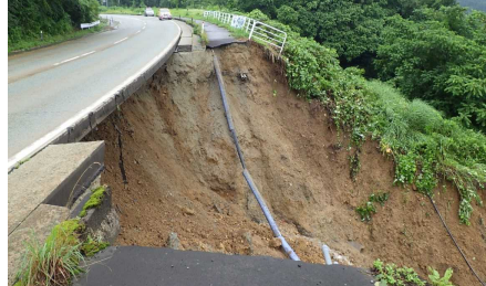
写真③ 舟形町長尾地区(道路崩壊状況)
