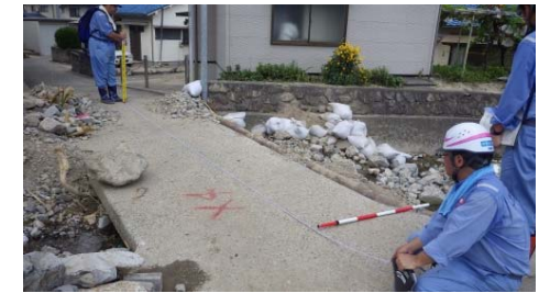
▲土石流被害調査状況
